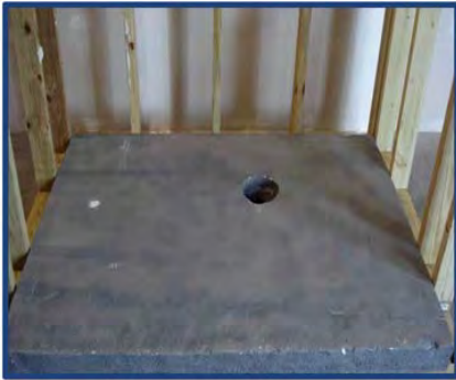
Fotografía de Instalación 1
