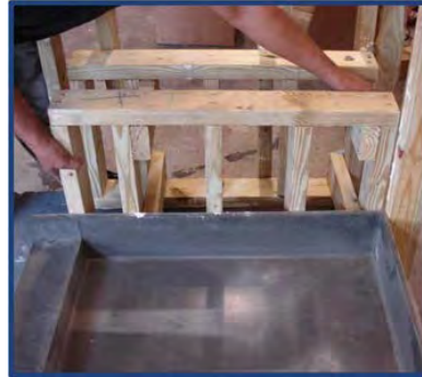
Fotografía de Instalación 2
