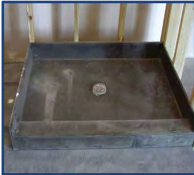
Fotografía de Instalación 3
