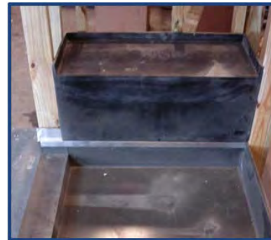
Fotografía de Instalación 6
