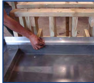
Fotografía de Instalación 4
