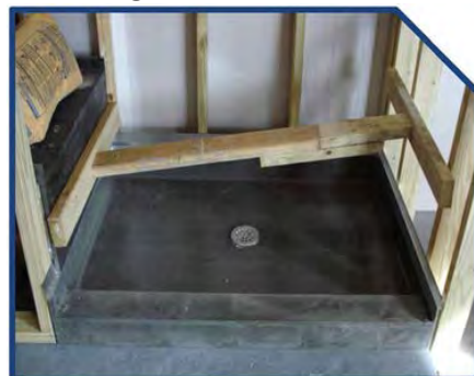
Fotografía de Instalación 8
