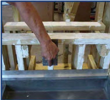
Fotografía de Instalación 5
