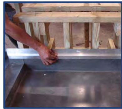
Fotografía de instalación 4
