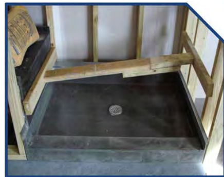
Fotografía de instalación 8
