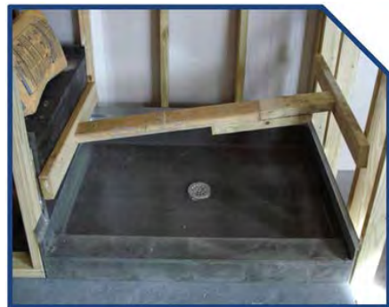
Fotografía de instalación 8
