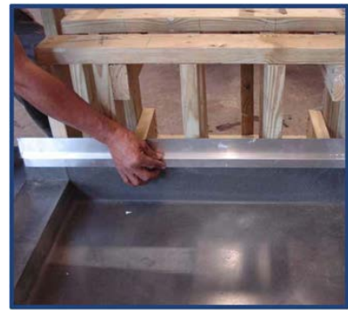
Fotografía de instalación 4
