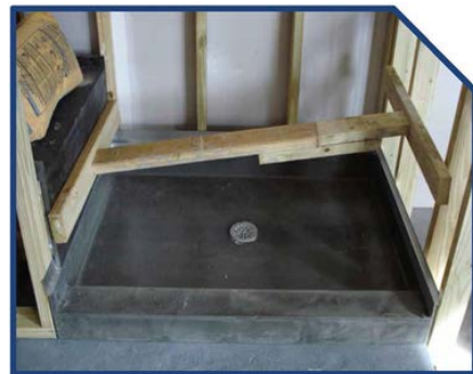
Fotografía de instalación 8
