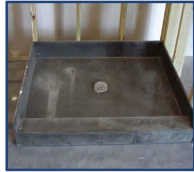
Fotografía de instalación 2
