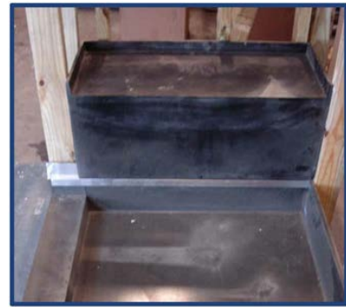
Fotografía de instalación 6
