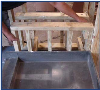
Fotografía de instalación 3
